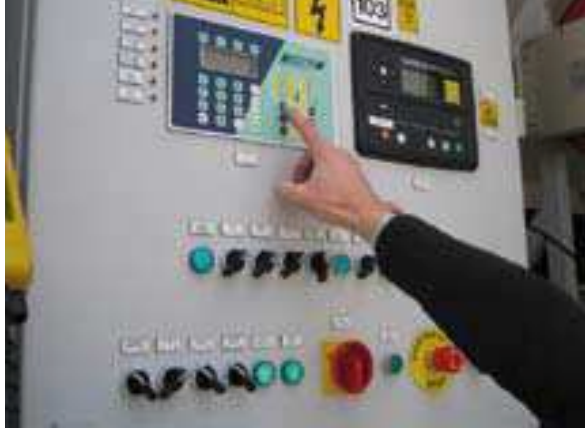
Les proportions du mélange souhaité sont introduites sur le panneau de commandes de l'armoire de commandes.
